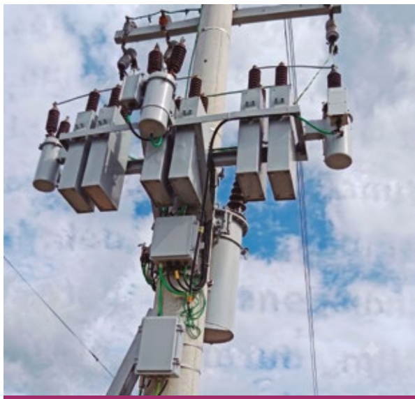
Fig. 2. Bancos automáticos para líneas de distribución aérea de media tensión
