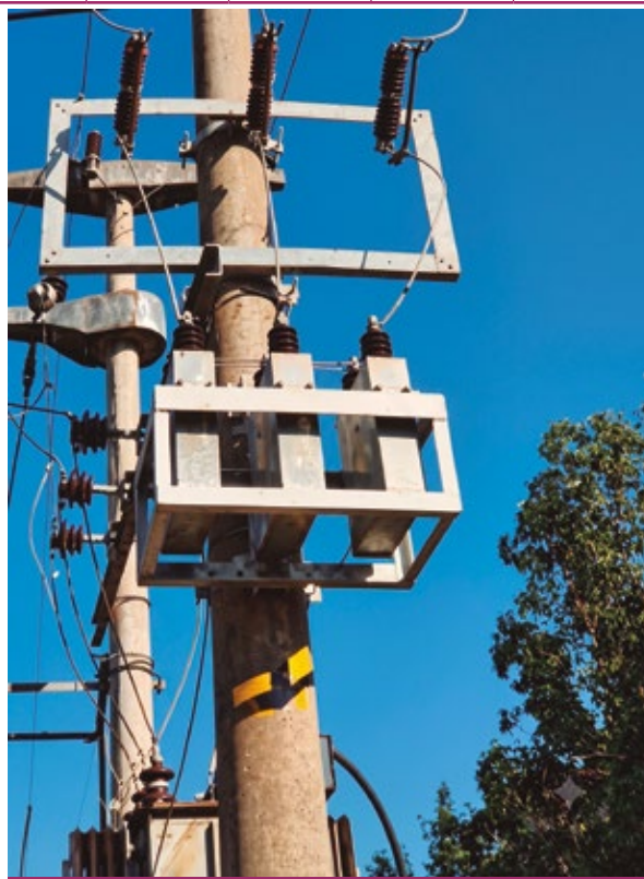
Fig. 1. Bancos fijos para líneas de distribución aérea de media tensión
