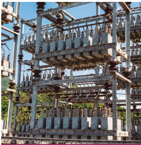
Figura 5. Bancos de alta tensión para estaciones transformadoras
