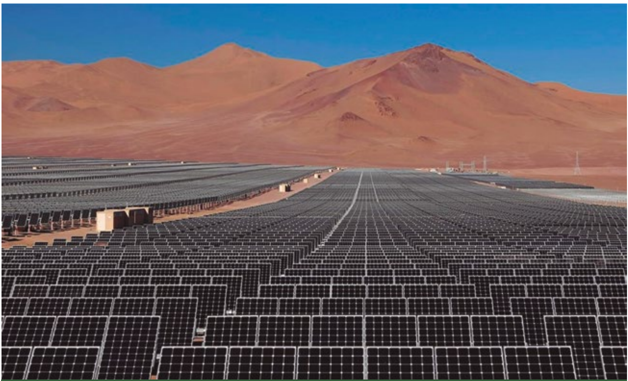
Planta Fotovoltaica Cauchari Fuente: EconoJournal
