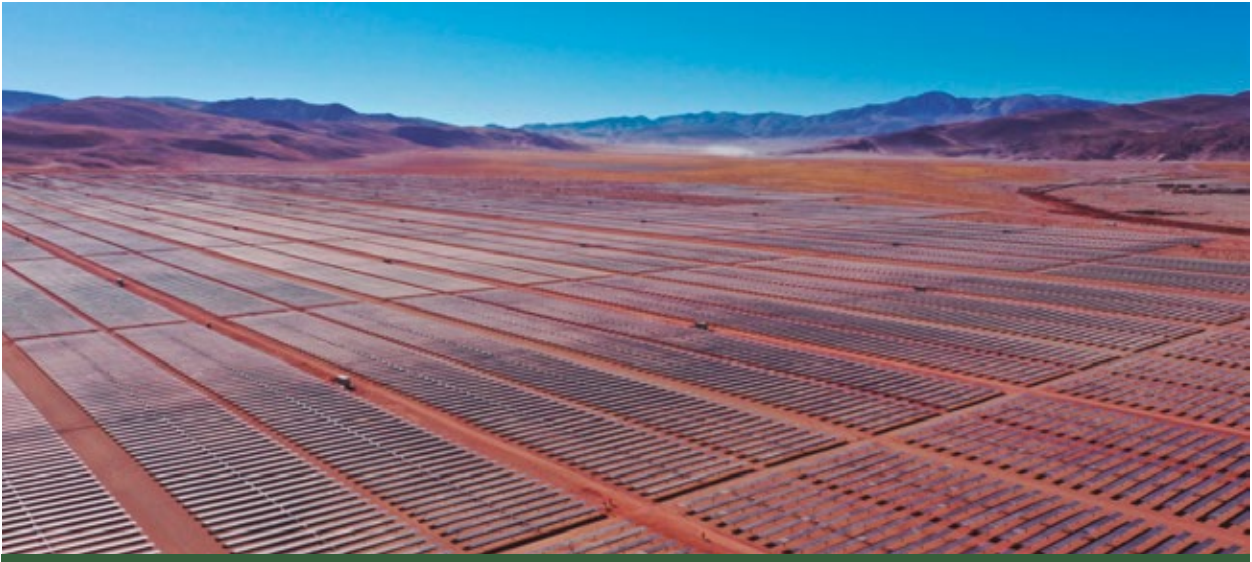
Planta Fotovoltaica Cauchari Fuente: EconoJournal
