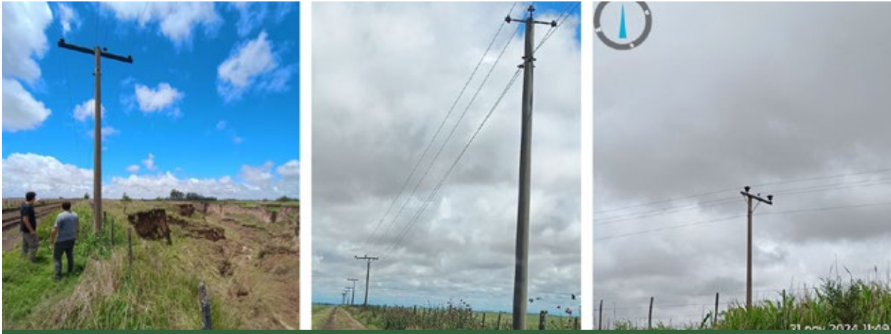
Infraestructura eléctrica Alimentador sur 13.2 kV Las Peñas Sud
