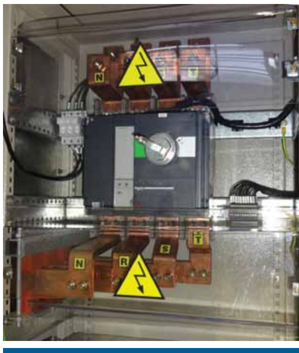
Barras protegida contra contactos
