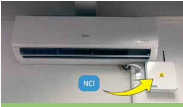
Figura 4. Módulo NCI v1.5 instalado en las aulas de la FRSF (UTN)
