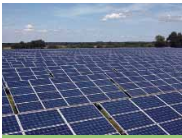
Figura 1. Aseguramiento de la eficiencia de parques solares con cámaras termográficas
