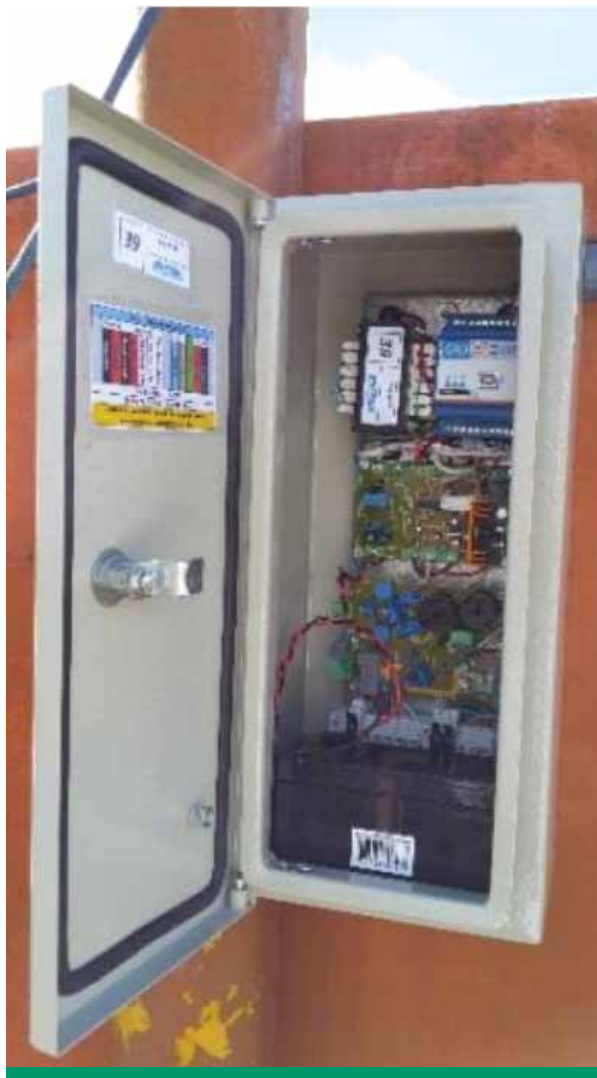
Figura 13. Circuito impreso instalado en campo
