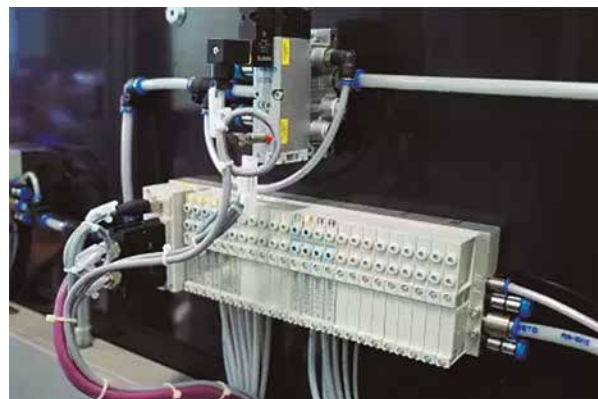
Un terminal de válvulas VTUG suministra la neumática en la estación de ajuste de luz.
