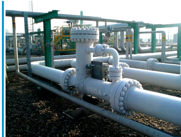
Figura 5. Instalación en Ripalta del caudalímetro multifase basado en muestreo isocinético
